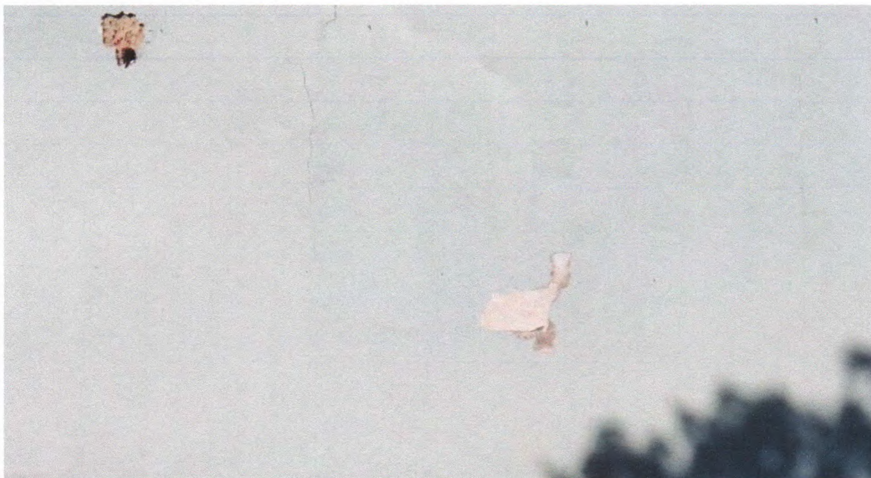
Figura 6: Fachada deteriorada e reboco de baixa resistência
