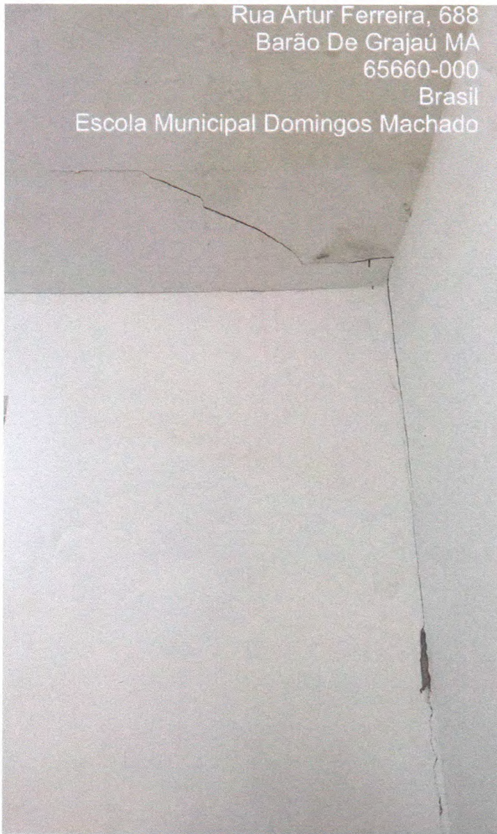
Figura 5: Presença de umidade no forro
